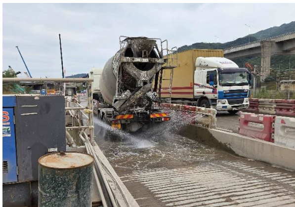
高壓自動洗車池
